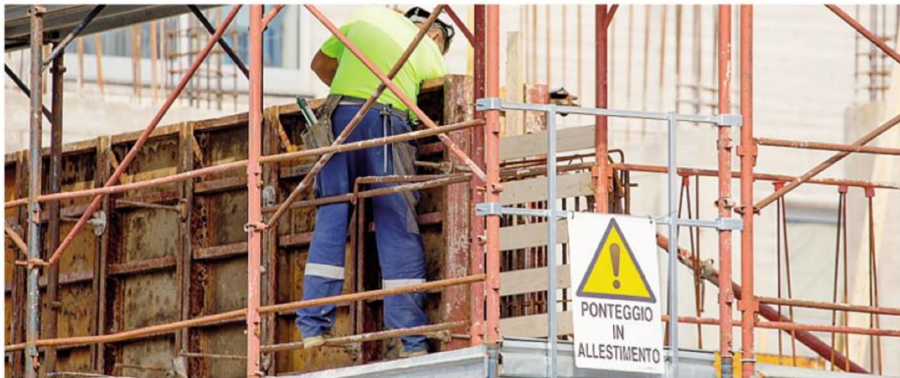
A dare il via all'indagine che ha portato fino ad Agrate le denunce nei confronti di un'azienda romana che non aveva mai eseguito i lavori di ristrutturazione
